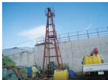
防災用水洗トイレのために井戸を掘ったところ、地下80数メートルから「名水」が湧き出しました。
